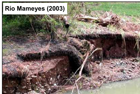
Ilustración 9.9: Falla de gaviones nuevos en "colchón" por socavación hidráulica.
