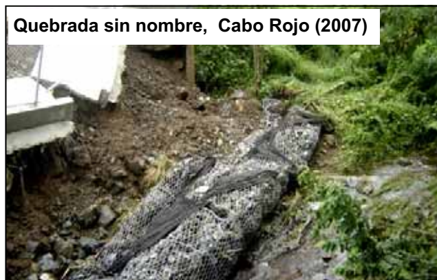
Ilustración 9.8: Falla de gaviones nuevos en "caja" por socavación hidráulica.
