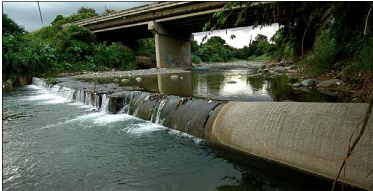
Ilustración 9.2: Tubería de 48 pulgadas expuesta por atrincheramiento del Río Toa Vaca.
