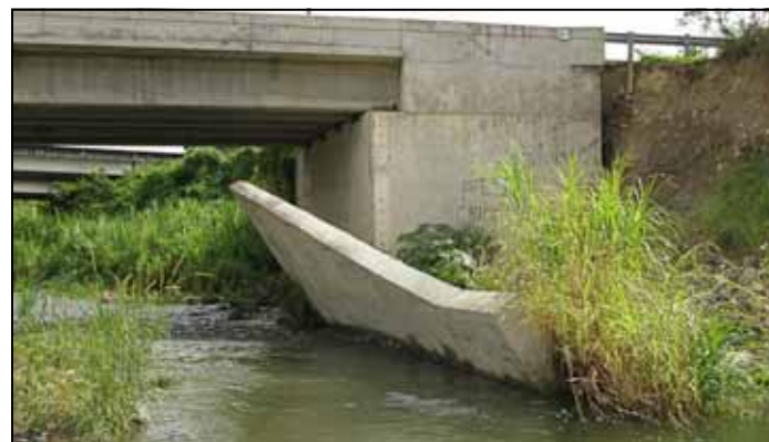
Ilustración 10.8: Colapso de estribo por atrincheramiento del lecho (2008).
