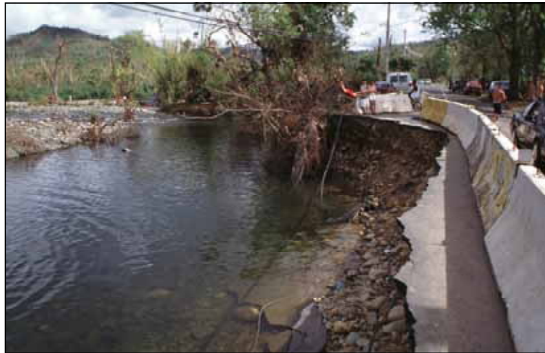
Ilustración 10.12: Erosión de talud en Río Mameyes luego del Huracán Georges, septiembre 1998.
