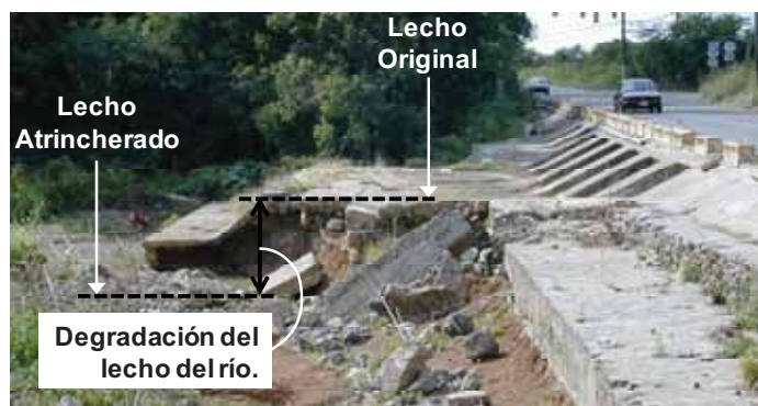
Ilustración 3.6: Puente vado de la carretera PR-3 en Salinas, mostrando proceso de atrincheramiento aguas abajo.
