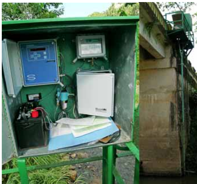
Ilustración 4.13: Estación de aforo del USGS en Río Tanamá.
