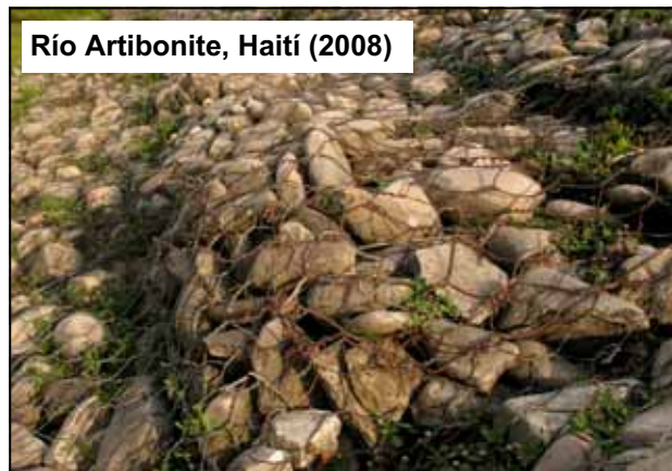
Ilustración 9.10: Deformación de las cajas de gaviones (primera etapa de falla por fuerza hidráulica).
