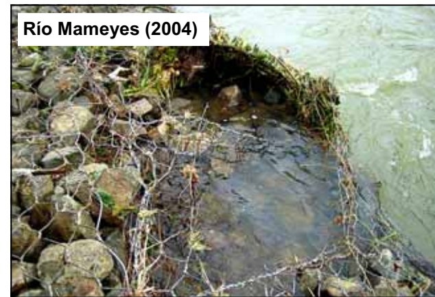
Ilustración 9.11: Ruptura de las cajas de gaviones (segunda etapa de falla por fuerza hidráulica).
