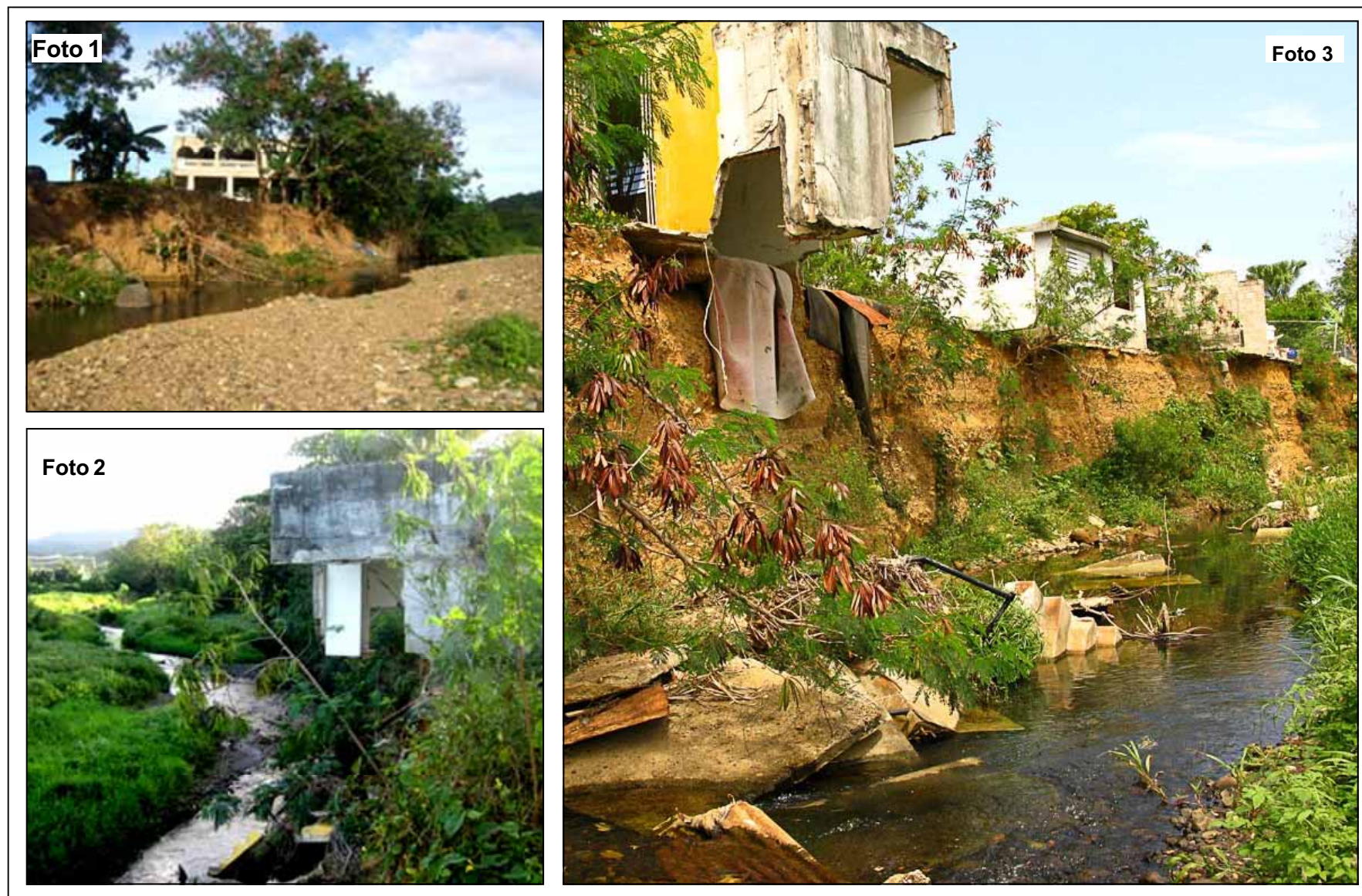
Ilustración 10.10: Vivienda de la Urbanización Alamar afectada por la migración del meandro.
