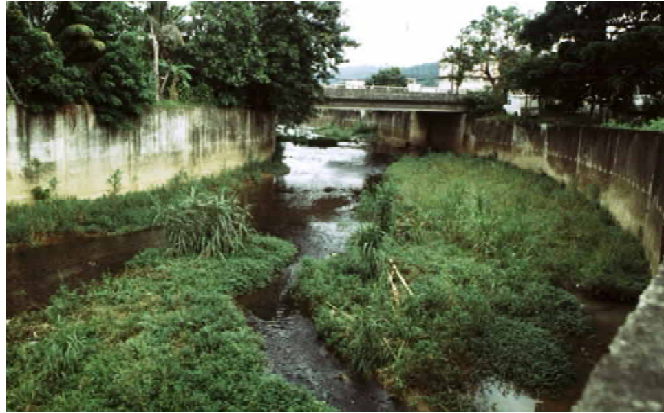
Ilustración 3.18: Canalización inestable debido a la acumulación de sedimentos, Río Yagüez, Mayagüez.
