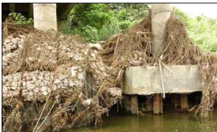
Ilustración 10.6: Falla de gaviones y pilastras expuestas del puente de la PR-52 en Río Inabón.
