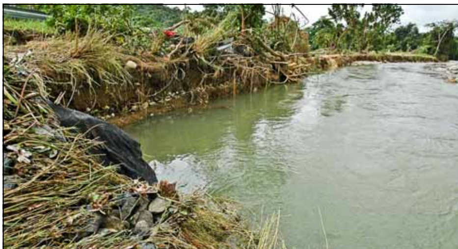
Ilustración 10.14: Límite aguas debajo de la instalación de los gaviones, señalando la erosión adicional (2004).
