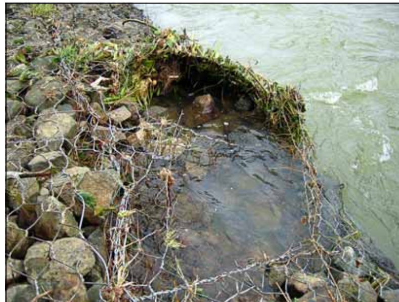
Ilustración 10.15: Falla de gaviones por fuerza hidráulica (2004).
