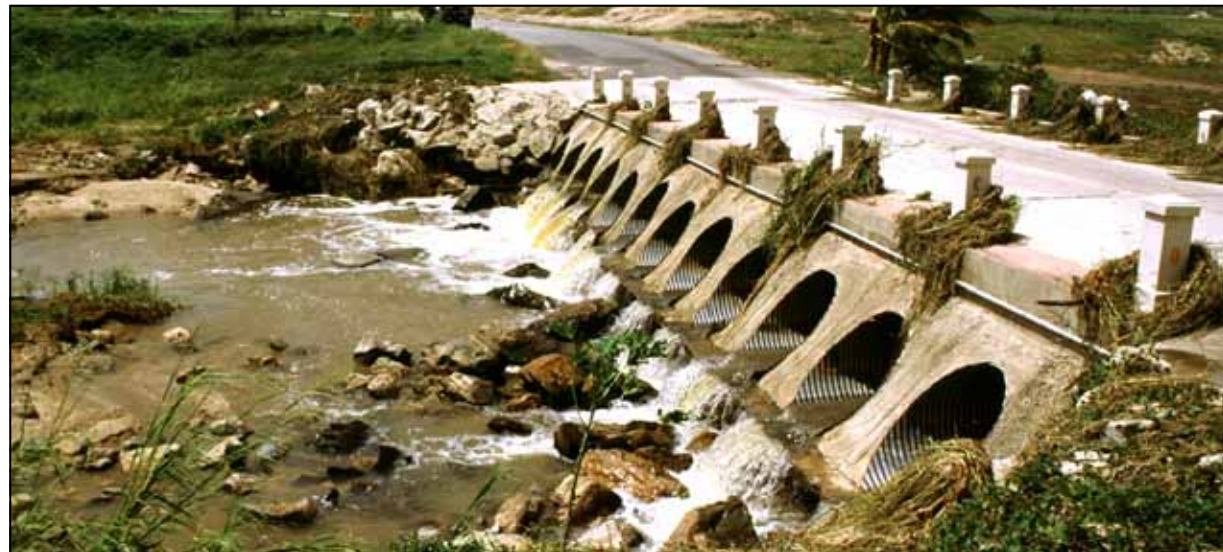
Ilustración 9.23: Puente vado en Humacao. La notable socavación de la cara aguas abajo demuestra que esta es la zona de mayor riesgo de falla estructural.
