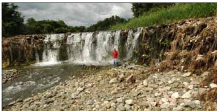
Ilustración 10.5: Salto de agua producido por la falla de gaviones.
