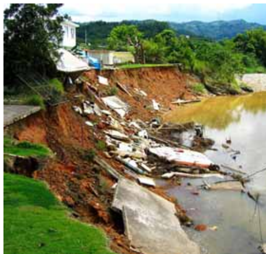
Ilustración 1.1: Daños causados a viviendas por migración de meandro en Río Turabo, Caguas.
