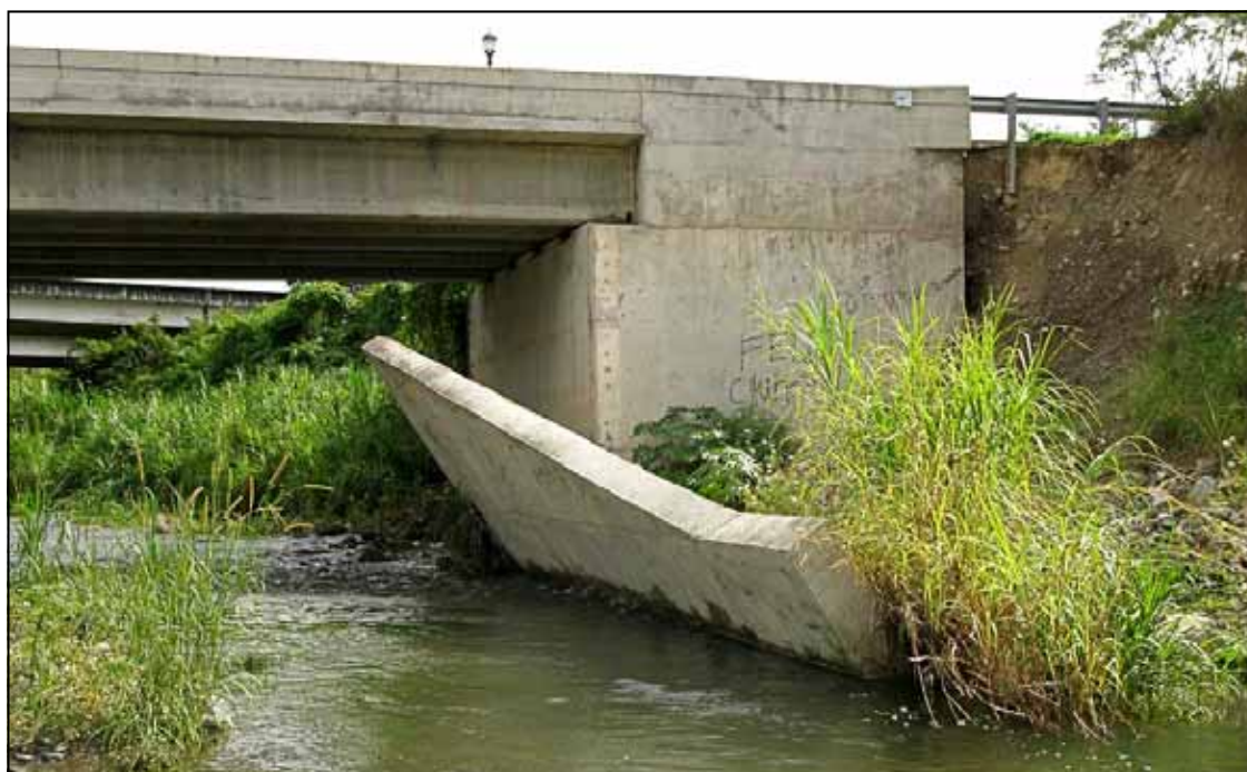
Ilustración 9.3: Colapso de estribo de puente por atrincheramiento de Río Inabón.
