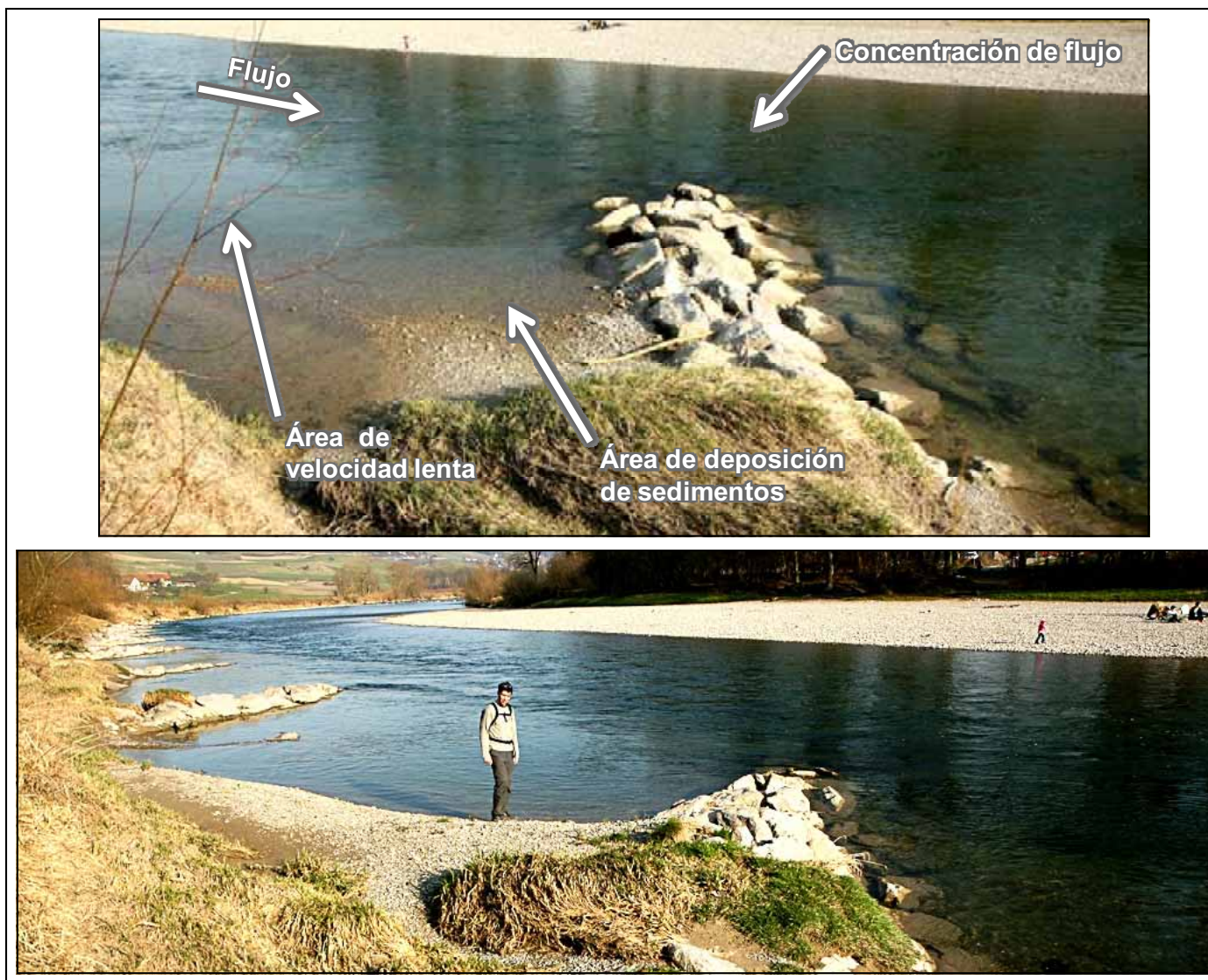
Ilustración 9.14: Guías de roca instalados en Suiza.
