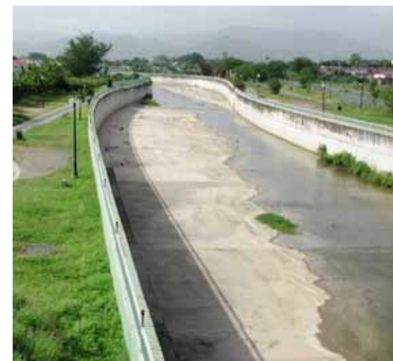
Ilustración 1.2: Canalización Río Portugués, Ponce, pérdida de hábitat y barrera migratoria.
