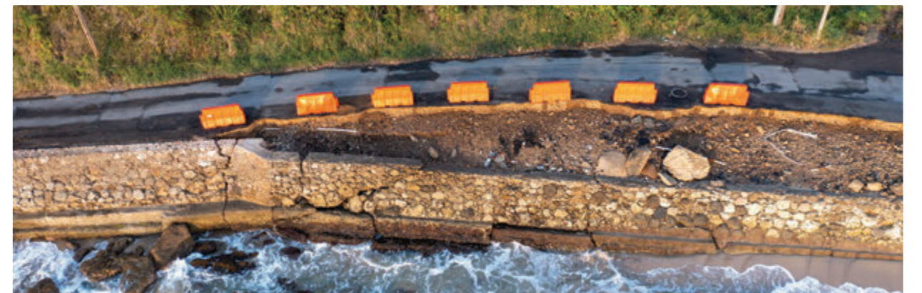
Estado del muro costero evidenciando el impacto de la erosión en la accesibilidad vial y paralela en la costa.
