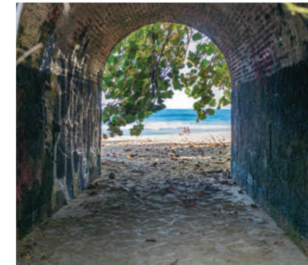
Infraestructura de la antigua vía del tren en la Playa Pools.
