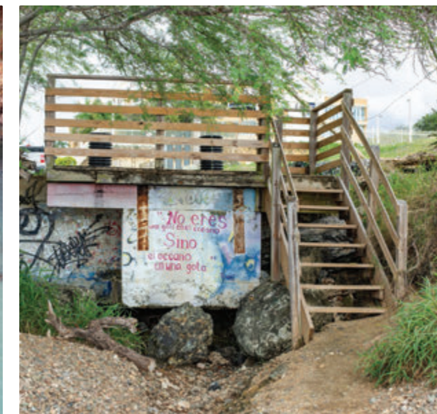
Accesibilidad limitada por erosión de escorrentías pluviales.
