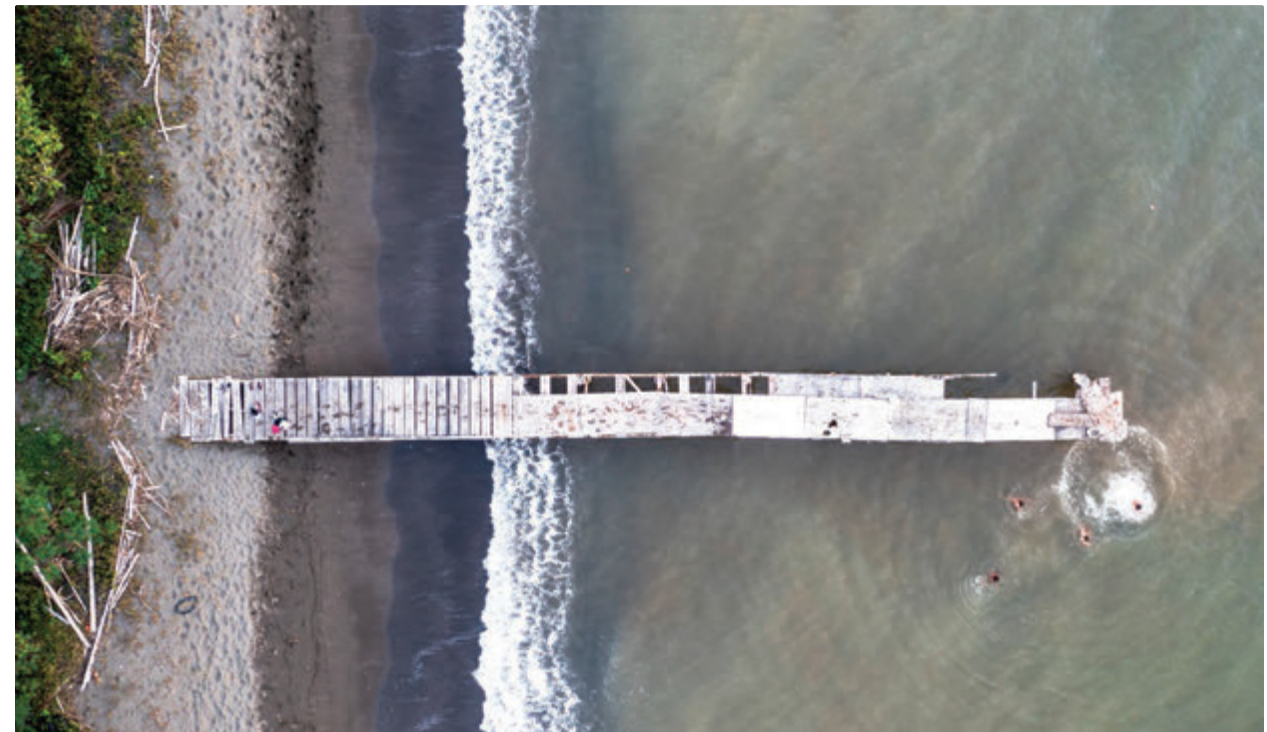
Infraestructura pesquera deteriorada que compromete la seguridad y la funcionalidad del acceso dentro del sistema costero urbano.
