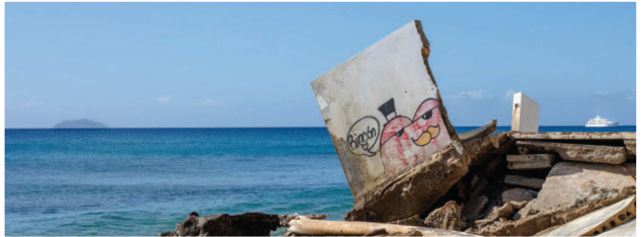
Residencia colapsada evidenciando procesos significativos de erosión costera.
