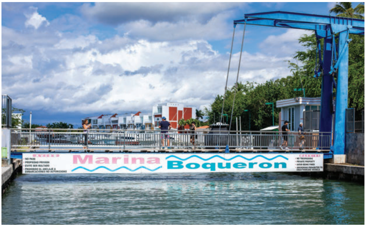
Puente elevadizo que conecta el acceso peatonal desde el poblado de Boquerón hasta el balneario.
