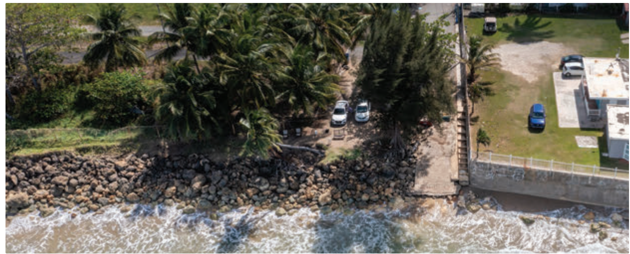
Revestimientos costeros informales que, además de contener el oleaje, interrumpen la accesibilidad paralela a la costa limitando el tránsito continuo por el litoral.
