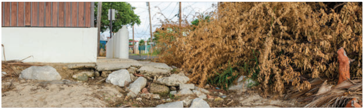
Transición del acceso a la costa obstaculizado por procesos de erosión asociado a escorrentías pluviales.
