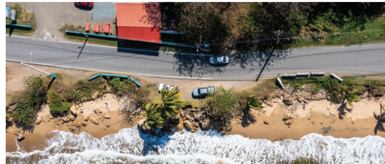
Tramo costero donde la erosión alcanza la carretera PR-441, reduciendo la franja de playa y evidenciando la vulnerabilidad de la infraestructura vial ante el retroceso del litoral.
