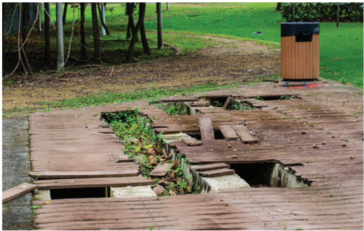
Infraestructura pesquera deteriorada que compromete la seguridad y la funcionalidad del acceso dentro del sistema costero urbano.
