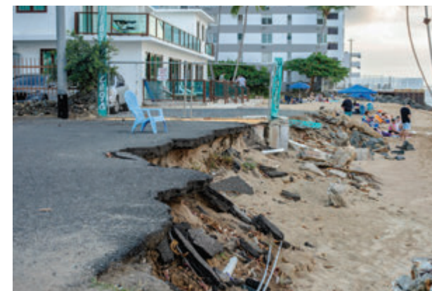
Infraestructura vial colapsada en el acceso a Playa Córcega.
