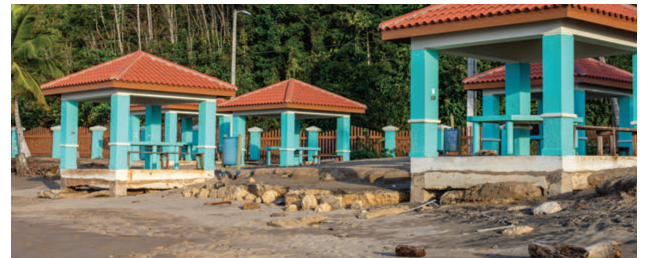
Erosión costera en el balneario Pico de Piedra que expone la base de los gazebos y compromete la estabilidad del terreno.
